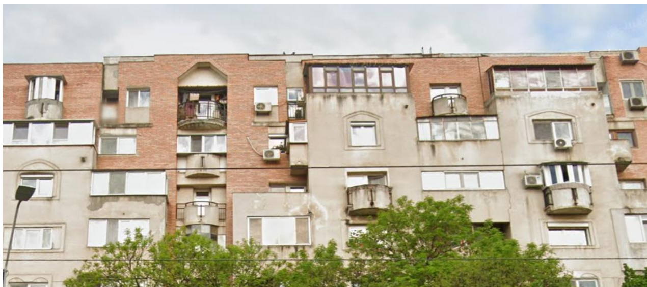
Figura 6 – Fațadă bloc degradat
